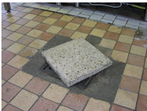
Obrázek 14: Před kontrolou - zcela nevhodné zakrytí odtoku vody
