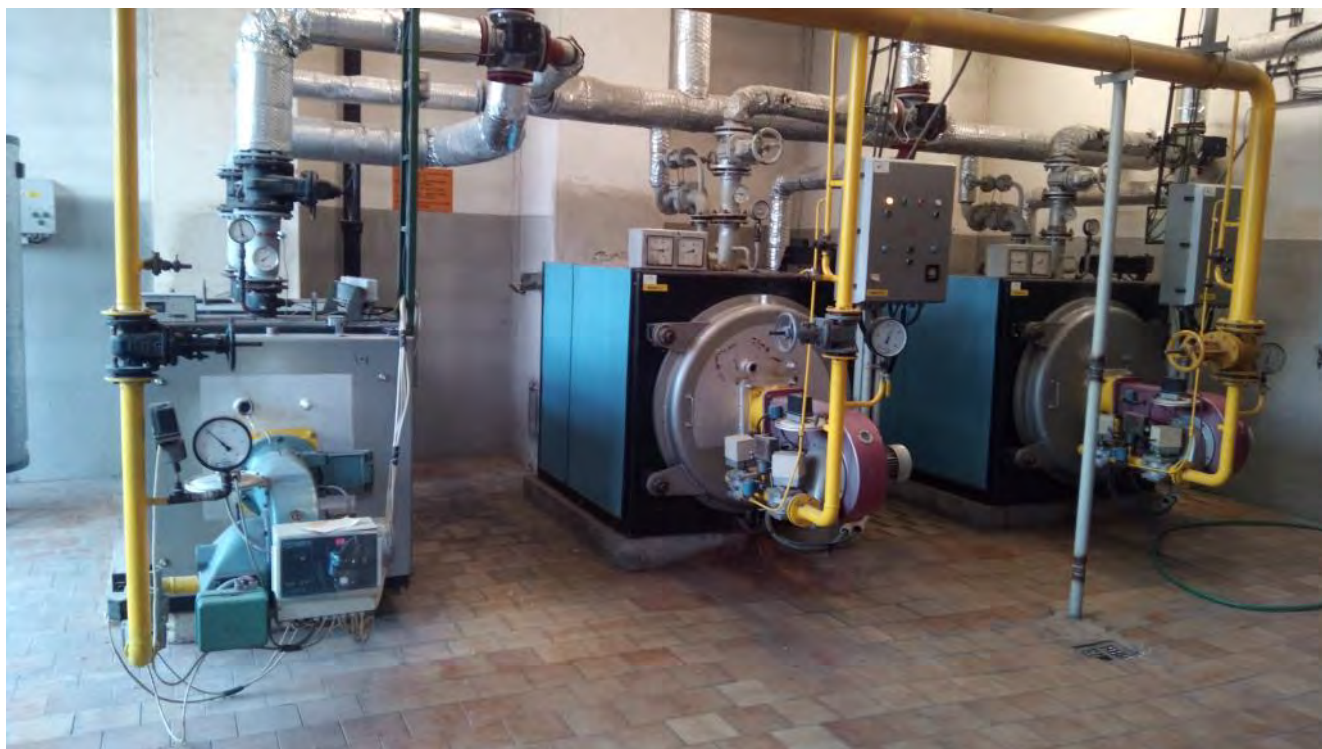
Obrázek 2 - Sestava kotlů v kotelně (zleva K1, K2, K3), přívod plynu, kondenzátní jímka
