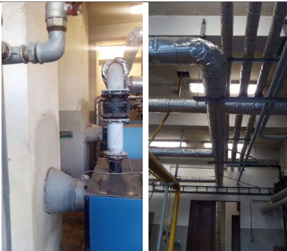
Obrázek 7 - Napojení kouřovodů a společný vývod topné vody s odbočkami ke kotlům
